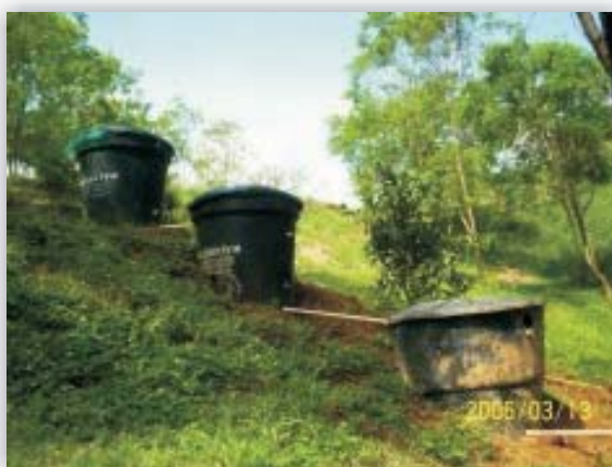
“Tanques de pre-tratamiento de líquido lixiviado”
