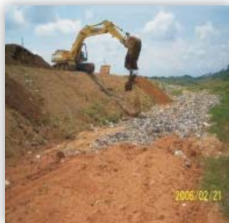
“Construcción de filtro perimetral y protección con geotextil y colchones contiguo a la Hacienda La Reja”
